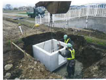
水槽設置状況
