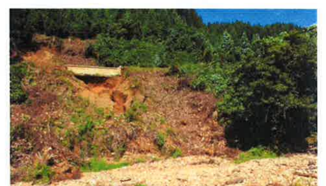
【金山町榊沢 幹線用水路溝畔決壊】
