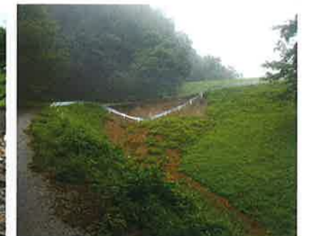
小以良川ダムの管理道路、5日からの豪雨で土砂崩れにより被災。(上部箇所)
