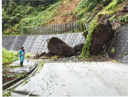
金山方面へ通水している、県営1号幹線用水路が、土砂崩れにより崩壊し、通水不能となりました。
