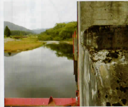
第2頭首工コンクリート剥離
