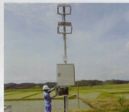
水位観測システム設置(太陽光発電)
