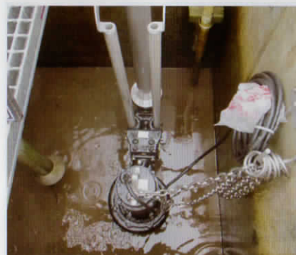
金山 NO46号揚水機設置
