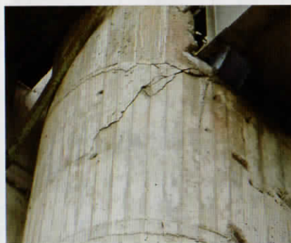
柗沢ダムコンクリートクラック
