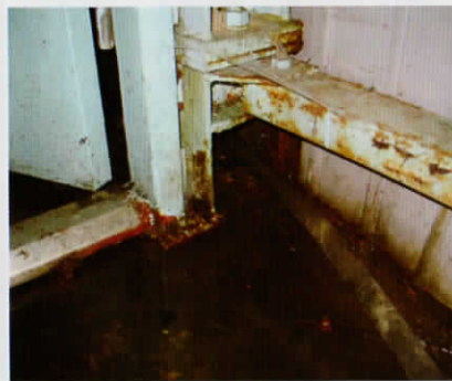
柗沢ダム監査廊扉腐食
