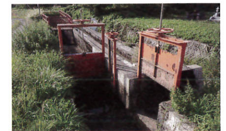
幹線水路ゲート劣化状況
