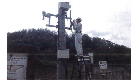
気象観測装置露点計保守点検
