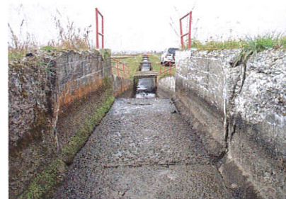
県営2号幹線水路劣化状況
