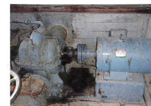
主電動機整備補修前
