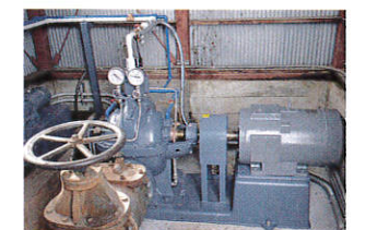
主電動機整備補修後
