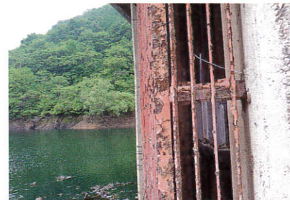
柵沢ダムスクリーン腐食状況
