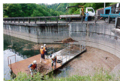
榊沢ダム湖面流木処理状況
